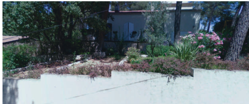
Mur de soutènement en béton lisse avec des redents discrets accompagnés de végétation
