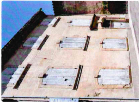
Exemple de RAVALEMENT D'ENTRETIEN à réaliser
